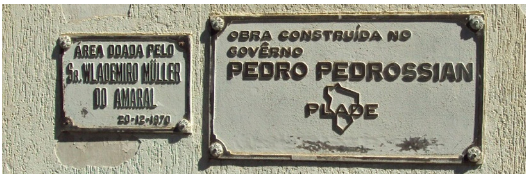
Figura 18 - Placas de inauguração dos prédios da Faculdade de Agronomia, em que o nome da Faculdade de Agronomia aparece apagado (esmerilhado).
